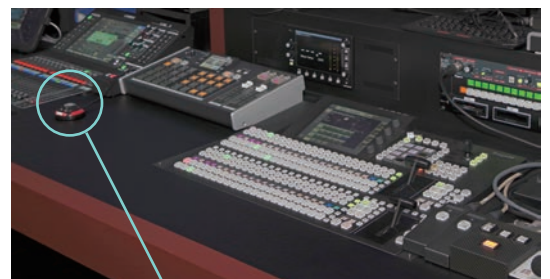
音声ミキサーの横にある外部押しボタン
