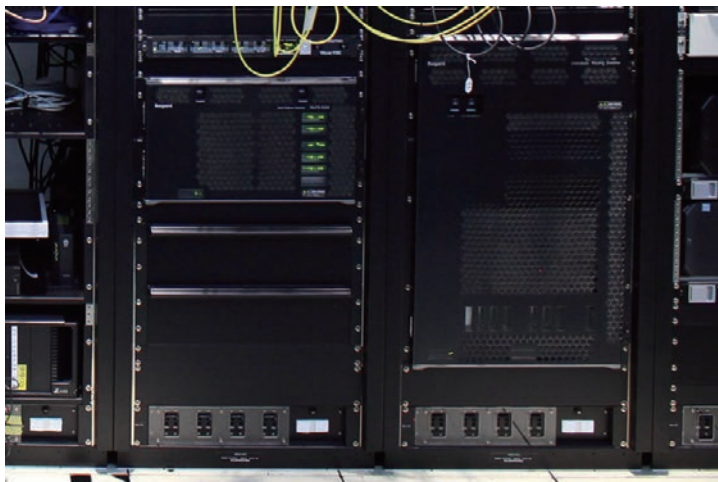
制作サブのラック室に収納されている、ルーティングスイッチャー「UHSM-220220」と中型スイッチャー「MuPS-5000」
