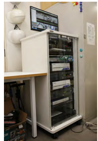
監視室に設置されたシステムラック。 58台のフルHDカメラの映像を 1ヶ月程度記録できるよう設計。
