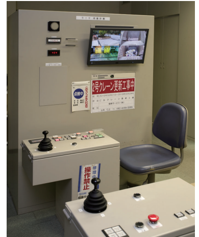
ごみクレーンモニタ盤
