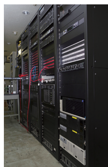
ルーター「UHSM-220220」ほか 各機器が設置されたラック室
