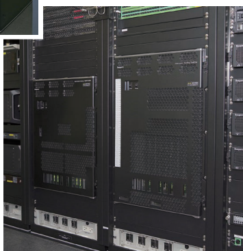
ラックに実装された スイッチャ本体 MuPS-5000 (左手) 大型ルータ UHSM-220220(右手)
