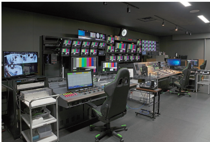
サブコントロールルーム
